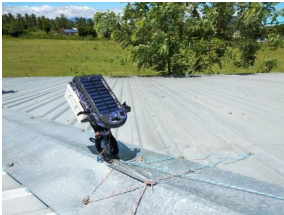
Gambar 10 Sistem 1 terpasang pada atap gedung UMGO
