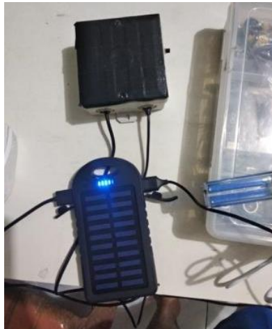
Gambar 6 Sistem yang terhubung ke solar power bank
